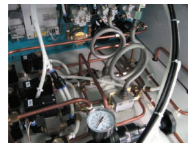
内部管路 Internal Pipeline
